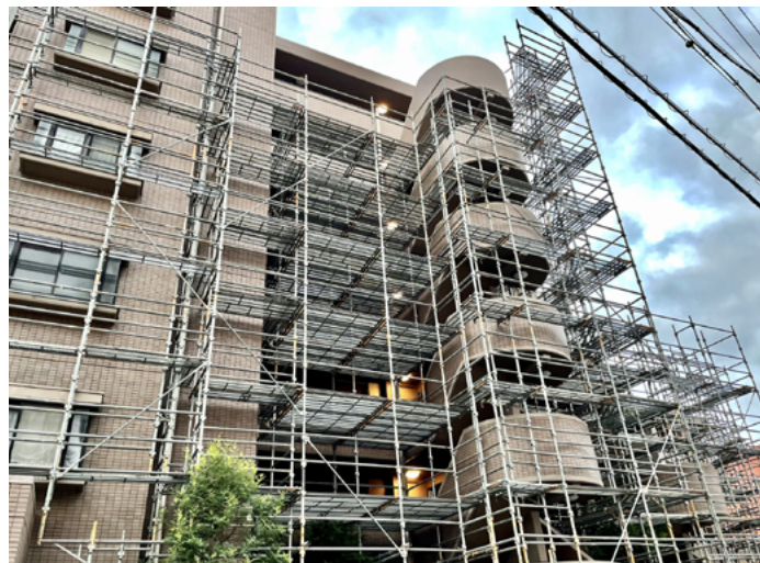
マンション全体の美観や防水性能を保つ上で欠かせない計画的な大規模修繕工事（写真と本文は直接関係ありません）
